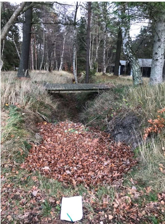
Intet vand. Haveaffald i grøft nærmest vej.
